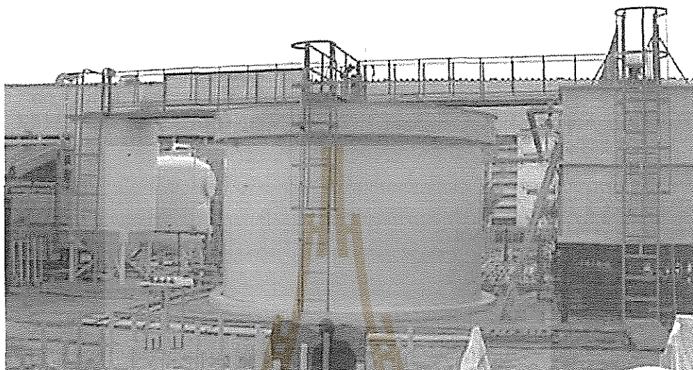
ภาพที่ 20 ระบบบำบัดน้ำเสียทางเคมี
