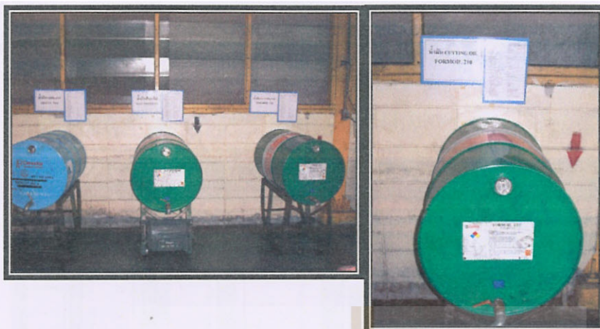
รูปที่ 2.12 แสดงถึงน้ำมันมีป้ายชื่อสารเคมีและ MSDS ติด
