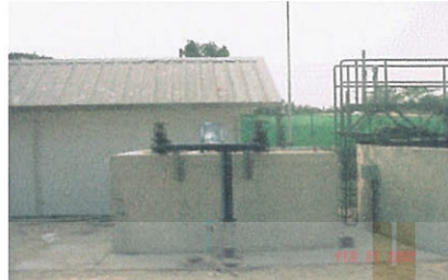
รูปที่ 2.17 แสดง Sludge Sump
