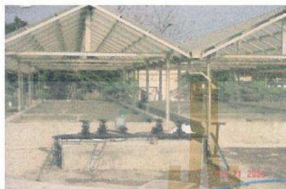
รูปที่ 2.18 แสดง Sand Drying Bed และFiltrated Sump
