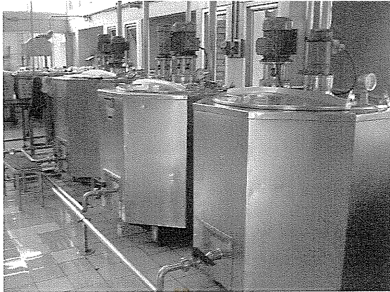
ภาพที่ 3 : ถังปรุ้งน้ำ
