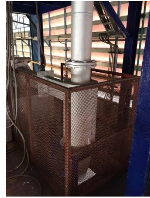
ข. ไซโคลนดักฝุ่น (Cyclone collector)
