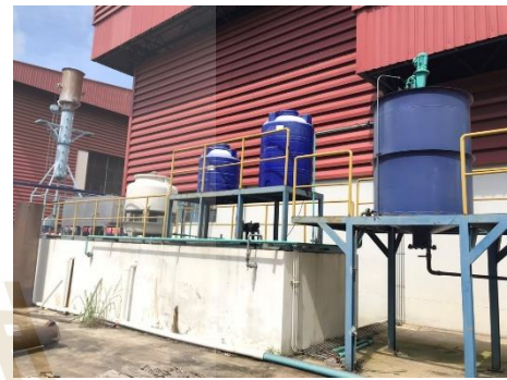
ง. ถังรวบรวมน้ำเสีย (Buffer tank)
