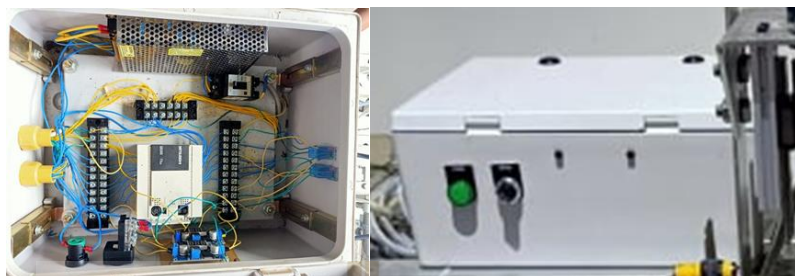
รูปที่ 3.15 ตู้ควบคุมไฟฟ้าสำหรับควบคุมการทำงานของเครื่องต้นแบบ
