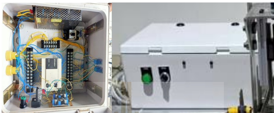
รูปที่ 4.16 ตู้ควบคุมไฟฟ้าสำหรับควบคุมการทำงานของเครื่องต้นแบบ
