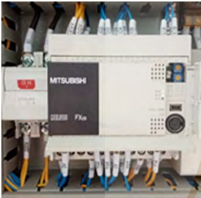
ภาพที่ 4.15 Programmable Logic Control (PLC)
