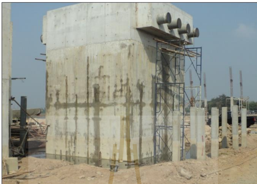
รูปที่ ก.13 ลักษณะน้ำรั่วซึมบ่อรับน้ำดิบ
