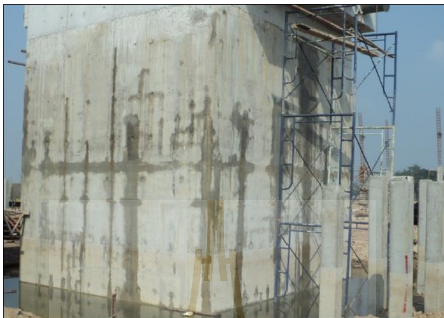
รูปที่ ก.15 ลักษณะน้ำรั่วซึมบ่อรับน้ำดิบ
