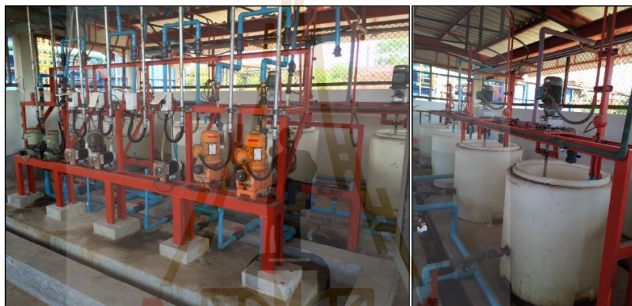
รูปที่ 2.5 ถังสารเคมีที่ใช้เติมให้กับระบบผลิตน้ำประปา (ระบบประปา มทส.)
