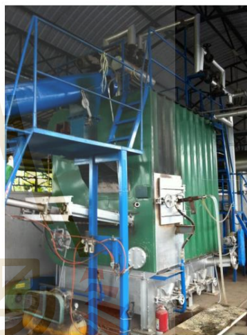
รูปที่ 5 เครื่องกำเนิดไอน้ำขนาดกำลังการผลิต 500 กิโลกรัมไอน้ำ/ชั่วโมง
