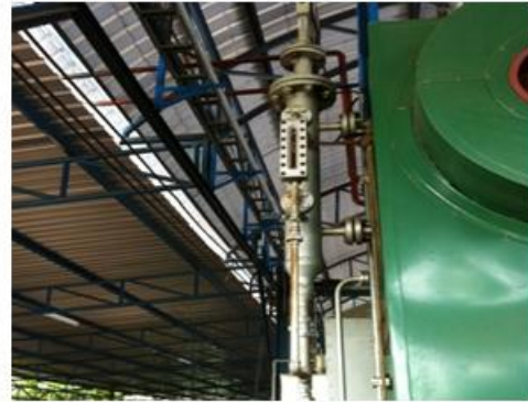
ข. ชุดควบคุม และวัดปริมาณน้ำอัตโนมัติ
