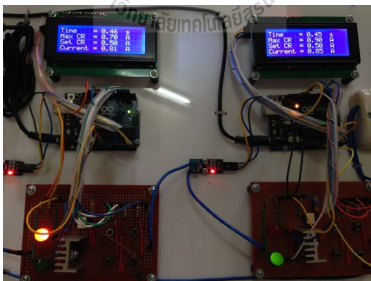
รูปที่ 3.22 การใช้โซลิตสเตตเบรกเกอร์ตัดวงจรแบบทันที 1 ตัวและตัดวงจรแบบหน่วงเวลา 1 ตัว
