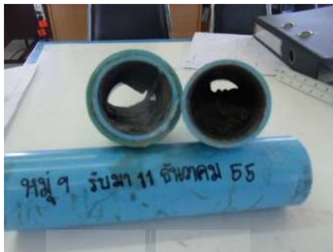
รูปที่ 1.6 ท่อจ่ายน้ำ บ้านหนองไฮ หมู่ที่ 9
