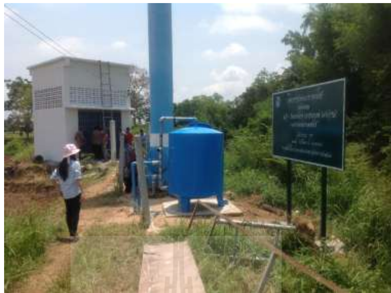
รูปที่ 4.7 ระบบประปาบ้านโคกสนวน หมู่ที่ 7
