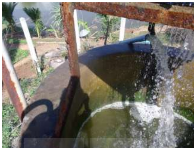
รูปที่ 1.3 ระบบกรองน้ำบาดาล บ้านหนองไฮ หมู่ที่ 9
