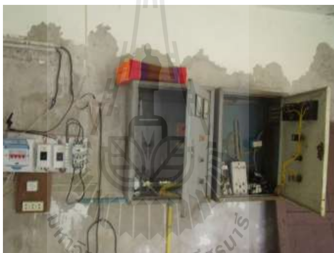
รูปที่ 1.7 ตู้ควบคุมเครื่องสูบน้ำ ภายในโรงสูบน้ำ บ้านตลาดโพธิ์ หมู่ที่ 3
