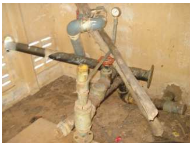
รูปที่ 1.5 โครงข่ายระบบท่อ+เครื่องสูบน้ำ ภายในโรงสูบน้ำ บ้านหนองไฮ หมู่ที่ 9
