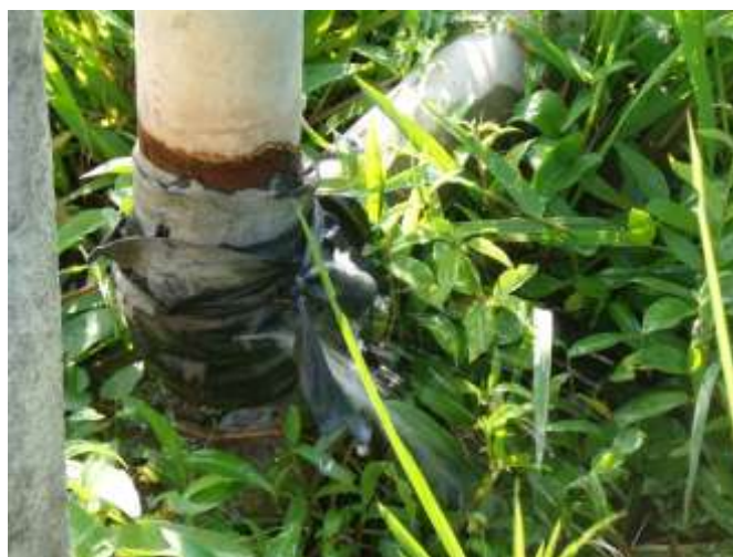
รูปที่ 1.8 ท่อจ่ายน้ำ บริเวณหอดึงสูง บ้านตลาดโพธิ์ หมู่ที่ 3
