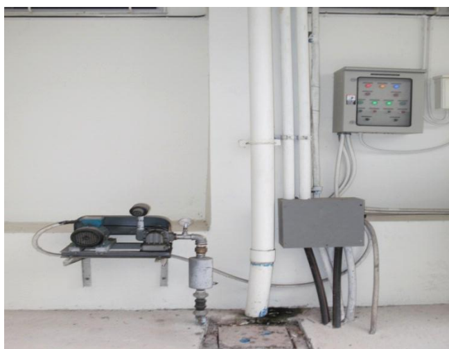
รูปที่ 4.14 ระบบบำบัดน้ำเสียแบบใช้อากาศ (Aerobic Process) ของอาคาร
