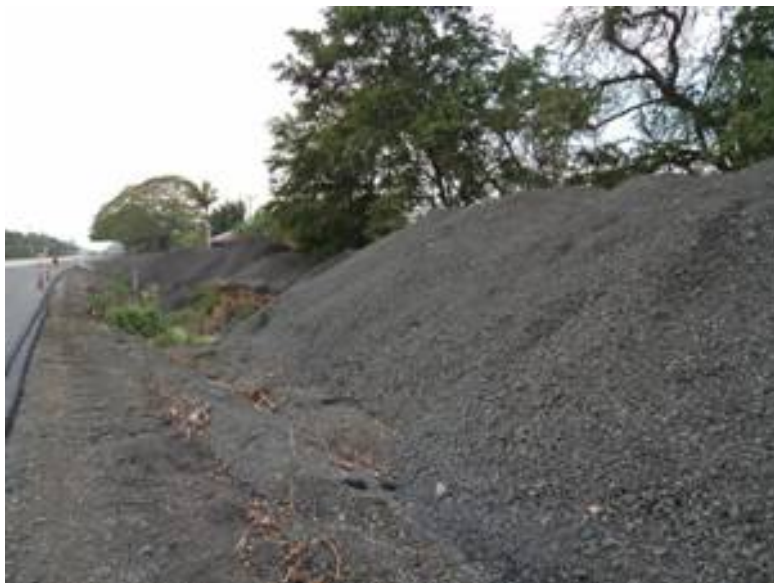
รูปที่ 1.2 ขยะผิวทางที่รื้อจากโครงการซ่อมถนนลาดยางโครงการซ่อมแซมจากอุทกภัยปี พ.ศ. 2554 ทางหลวงหมายเลข 311 อำเภอเมือง จังหวัดลพบุรี (Suebsuk et., 2013)
