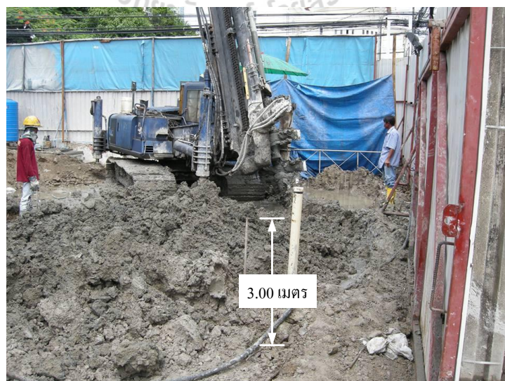
รูปที่ 4.25 การรบกวนจากการติดตั้ง SCC ที่ตำแหน่งท่อ I-1
