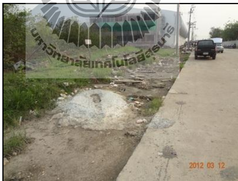
รูปที่ 4.6 คอนกรีตที่เสียจากการเทแต่ละครั้ง
