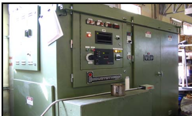
1) อุปกรณ์ควบคุมการจ่ายไฟฟ้า
