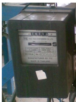
รูปที่ 3.21 มิเตอร์ไฟฟ้า
