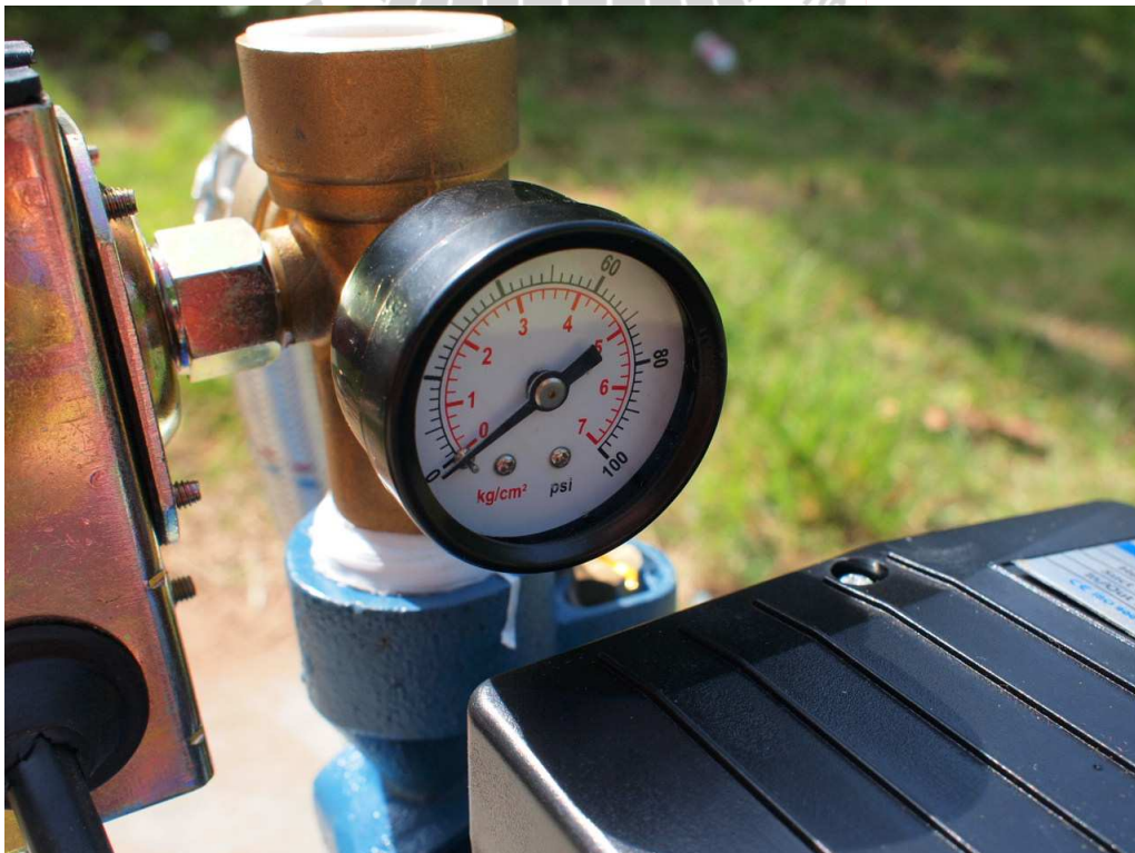
รูปที่ 3-11 มาตรวัดความดันบนปั๊มสำหรับหมุนเวียนน้ำโคลน
