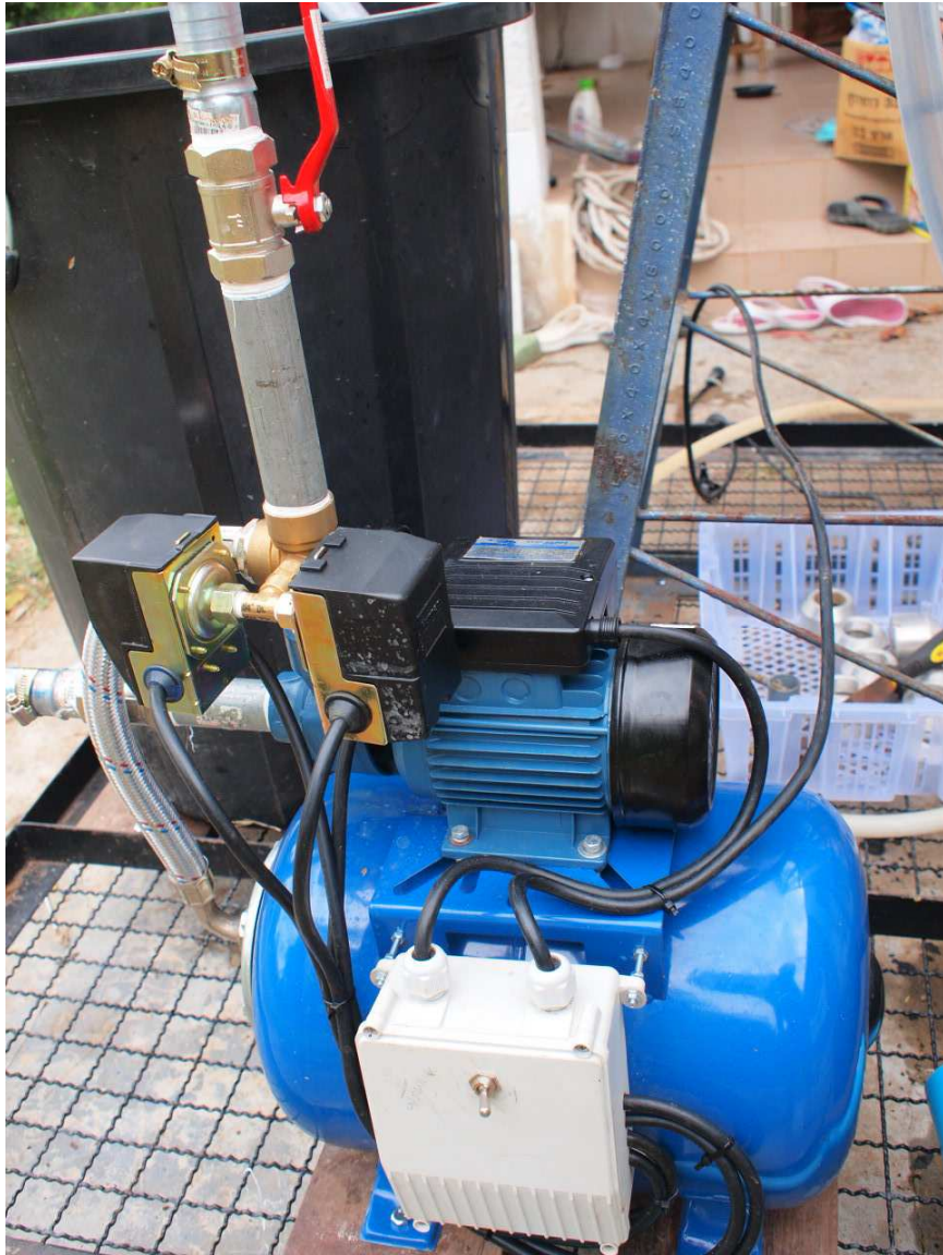
รูปที่ 3-25 ภาพแสดงอุปกรณ์ปั้มน้ำโคลนพร้อมอุปกรณ์ติดตั้งสมบูรณ์
