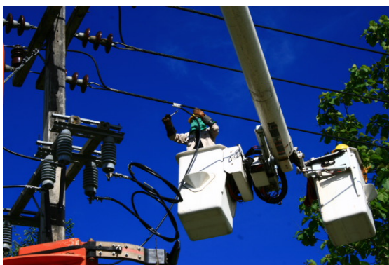
รูปที่ 7.1 การปฏิบัติงานของบุคลากรทางไฟฟ้าด้วยกระเช้ารถยกของการไฟฟ้า
