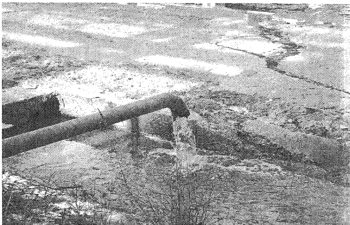
รูปที่ 5 ท่อที่ระบายน้ำทิ้งของ Cooling TG4 ไปตามรางเพื่อเข้าสู่ระบบบำบัด
