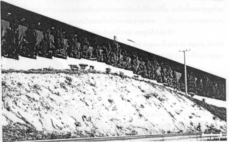
รูปที่ ก-46 ความลาดเอียงมวลหินแบบแผ่นบริเวณหลักกิโลเมตรที่ 134 ของทางหลวงหมายเลข 2 บริเวณอำเภอมากเหล็ก จังหวัดสระบุรี (Slope No.17)
