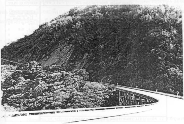
รูปที่ ก-71 ความลาดเอียงมวลหินกึ่งดินดานบริเวณหลักกิโลเมตรที่ 19-20 ของเส้นทางหลวงหมายเลข 12 ชุมแพ หล่มสัก (Slope No.26)
