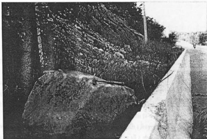
รูปที่ ก-34 มวลหินทรายขนาด 2 \times 1 \times 1 \text{ m}^3 ที่ ร่วงหล่นที่ฐานของความลาดเอียงมวลหิน (Slope No.13)
