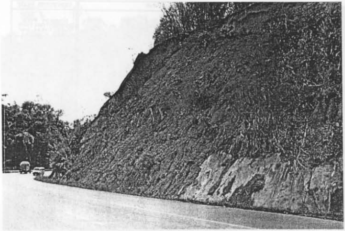
รูปที่ ก-97 ความลาดเอียงมวลหินกิ่งดินคานบริเวณหลักกิโลเมตรที่ 36+600 ของเส้นทางหลวงหมายเลข 12 ชุมแพ หล่มสัก (Slope No.34)
