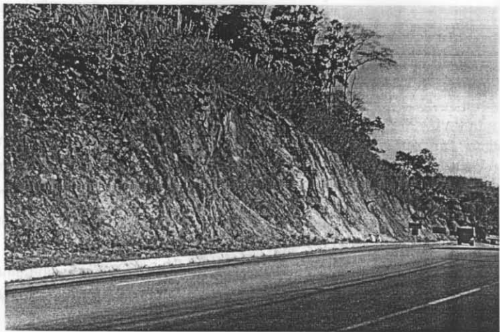
รูปที่ ก-114 ความลาดเอียงมวลหินบริเวณหลักกิโลเมตรที่ 62+500 ของเส้นทางหลวงหมายเลข 105 ตาก แม่สอด (Slope No.38)
