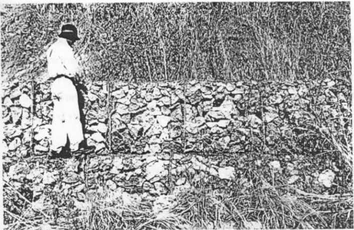
รูปที่ ก-92 ลักษณะของ Gabion ที่วางอยู่ที่บริเวณฐานของความลาดเอียงมวลหินเพื่อป้องกันการกรดิ่งของหินที่ร่วงหล่น (Slope No.32)
