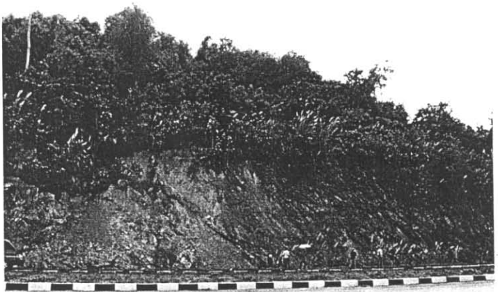
รูปที่ ก-19 การพังทลายแบบรูปโค้ง ของมวลหินดินดานบริเวณหลักกิโลเมตรที่ 92+600 ของเส้นทางหลวงหมายเลข 340 (Slope No.7)
