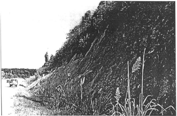
รูปที่ ก-18 ความลาดเอียงมวลหินบริเวณหลักกิโลเมตรที่ 92+600 ของเส้นทางหลวงหมายเลข 340 ซึ่งมีลักษณะของมวลหินที่มีรอยแตกมาก และ กระบวนการผุพังอยู่ในอัตราสูง (Slope No.7)
