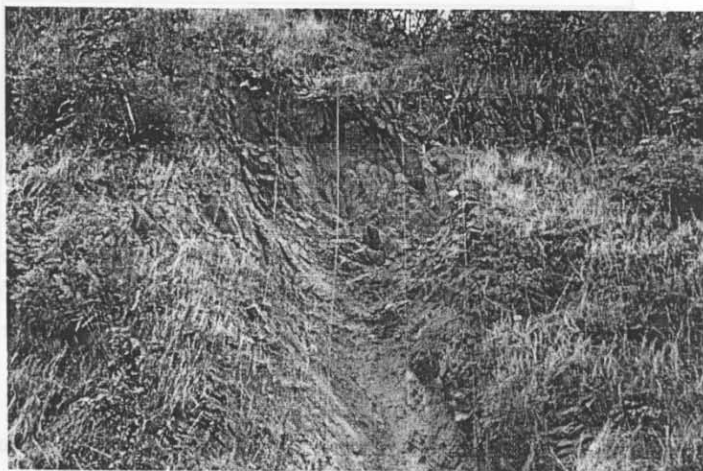
รูปที่ ก-139 การพังทลายแบบ ไหลโคลนที่บริเวณคิ้วหน้าของความลาดเอียงมวลหินดินดาน และลักษณะของคาข่ายลวดที่ใช้ป้องกันการร่วงหล่นของก้อนหิน (Slope No.46)
