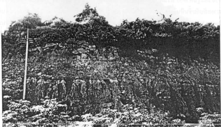
รูปที่ ก-33 ความลาดเอียงมวลหินบริเวณหลักกิโลเมตรที่ 196 ของทางหลวงหมายเลข 2 บริเวณ เขื่อนลำตะคอง จังหวัดนครราชสีมา (Slope No.13)
