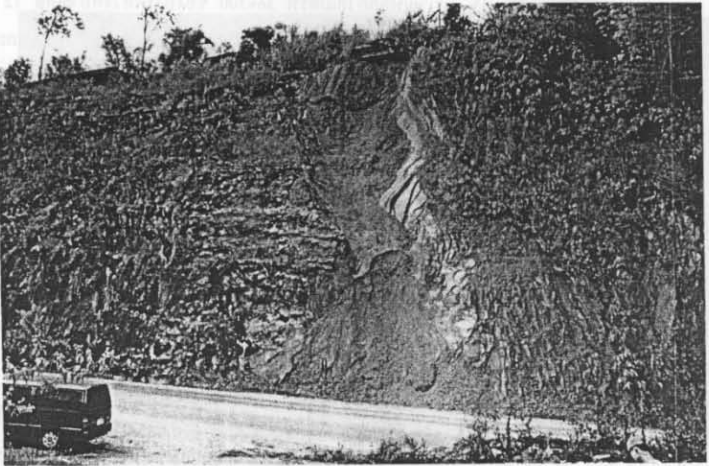
รูปที่ ก-93 ความลาดเอียงมวลหินกิ่งดินดานบริเวณหลักกิโลเมตรที่ 36+300 ของเส้นทางหลวงหมายเลข 12 ชุมแพ หล่มสัก (Slope No.33)
