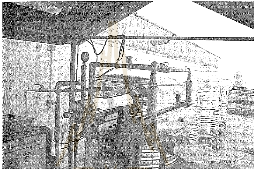
ภาพที่ 2.9 แนวท่อก่อนการปรับเปลี่ยน
