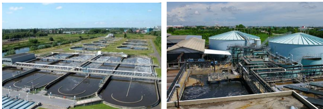
รูปที่ 1.2 บ่อพักน้ำเสียจากโรงงานอุตสาหกรรม
