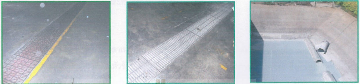
รูปที่ 8 แสดงลักษณะของรางระบายน้ำเสียและท่อที่ปล่อยลงสู่อำบัต
