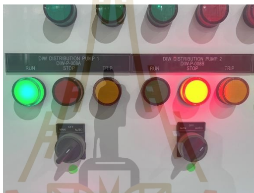
รูปที่ 3.4 สวิตช์สตาร์ทปั๊มน้ำ DIW Distribution
