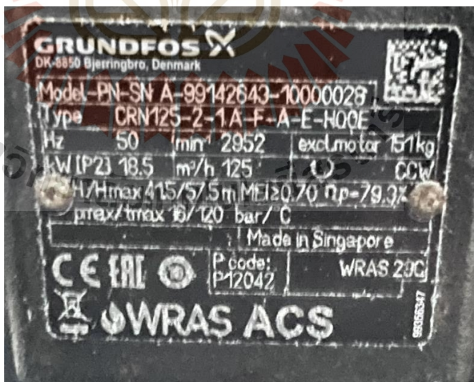
รูปที่ 4.13 เนมเพลตปั้มน้ำ DIW Distribution
