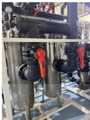
รูปที่ 3.11 วาล์วของระบบถังกรอง Final Filter
