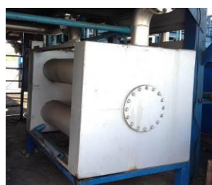
ระบบทำความสะอาดแก๊สเชื้อเพลิง (แบบถุงกรอง)
