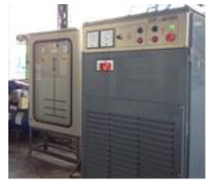
อุปกรณ์ควบคุมการทำงานของ ระบบ
