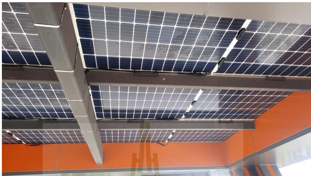
รูปที่ 4.5 การติดตั้งระบบพลังงานเซลล์แสงอาทิตย์แบบสองหน้าที่ได้ออกแบบที่สถานีอัดประจุไฟฟ้า
