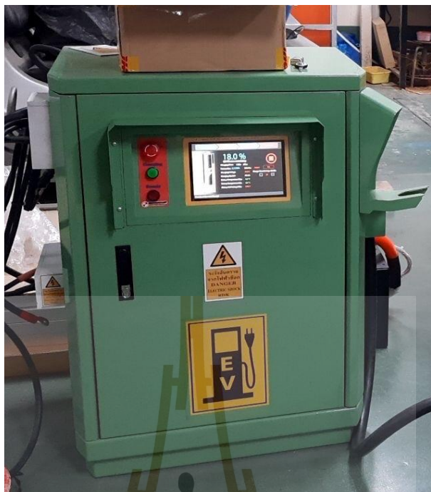
รูปที่ 4.22 ตู้อัดประจุแบบปรับค่าได้
