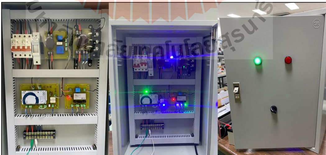
รูปที่ 6.1 ชุดต้นแบบการตามรอยจุดกำลังไฟฟ้าสูงสุดของเซลล์แสงอาทิตย์ 3 kW
