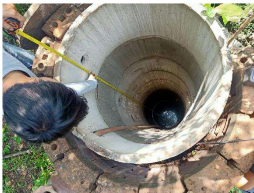
รูปที่ 3.25 วัดระดับความลึกของบ่อจากตำแหน่งปากบ่อถึงก้นบ่อ (บริเวณที่มีน้ำ)
