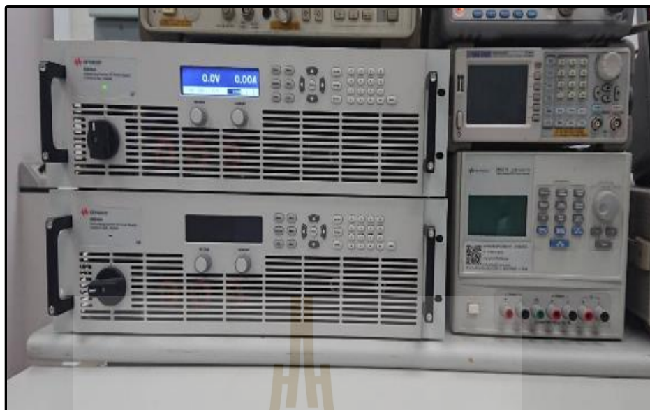
รูปที่ 4.4 ชุด Power supplys
