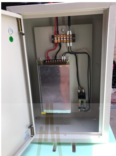
รูปที่ 4.44 แสดงในส่วนการติดตั้งอุปกรณ์ภายในกล่องบรรจุ แปลงแหล่งจ่ายกระแสสลับเป็นกระแสตรง
