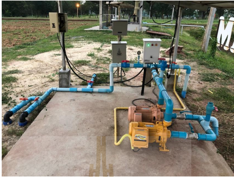
รูปที่ 4.2 ระบบปั้มน้ำอัตโนมัติ
