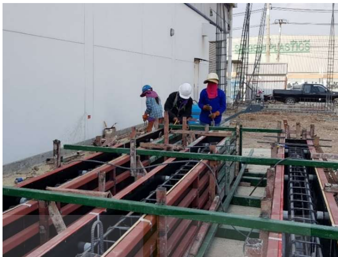
รูปที่ 2.2 การก่อสร้างคานคอนกรีตเสริมเหล็กสำเร็จรูป
