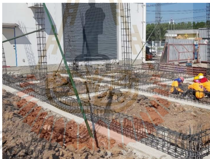
รูปที่ 2.1 การก่อสร้างคานคอดินแบบหล่อในที่
