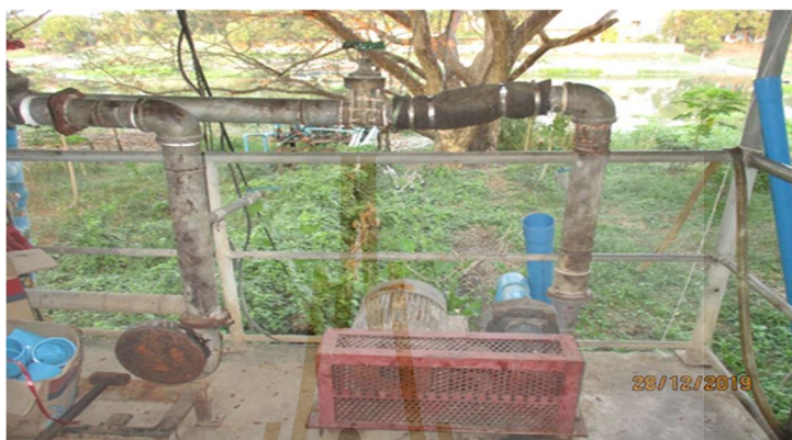
รูปที่ 3.2 ปั๊มน้ำแบบแรงเหวี่ยงโดยใช้มอเตอร์ไฟฟ้าเป็นต้นกำลัง
