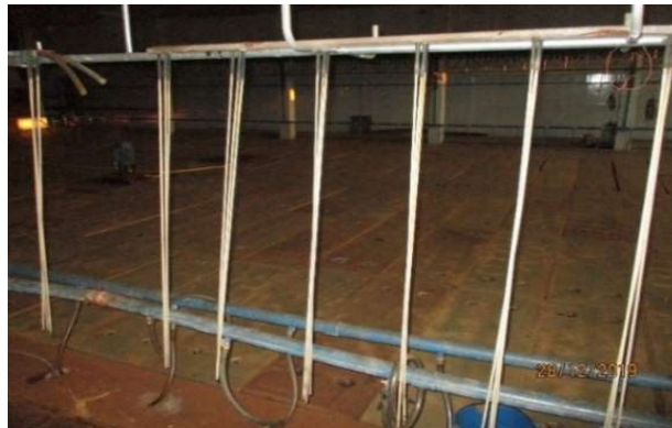
รูปที่ 3.11 ท่อลมเป่าน้ำภายในช่อง
