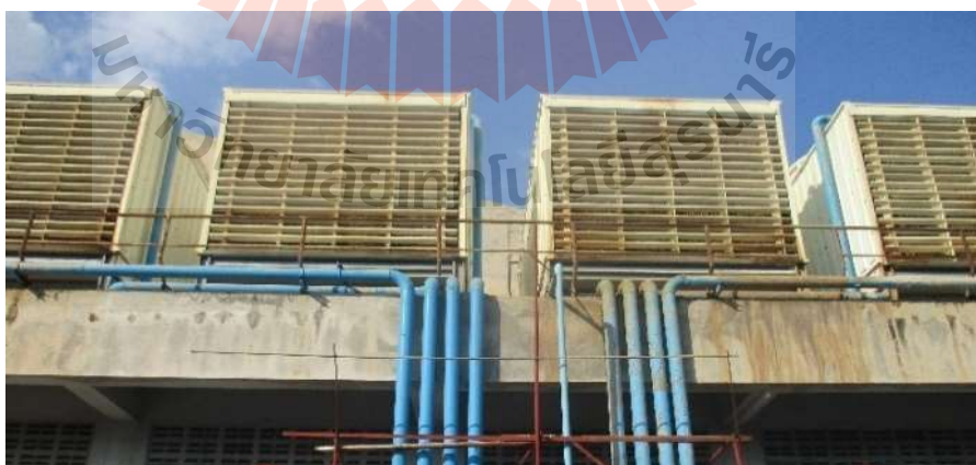
รูปที่ 3.21 หอผึ่งเย็น (Cooling Tower)
