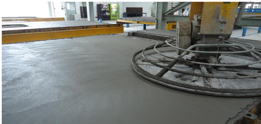
รูปที่ 2.14 การขัดผิวหน้าคอนกรีต ( Pruksa Real Estate , 2015)
