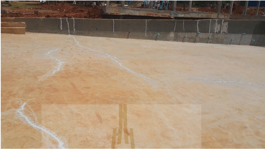
รูปที่ ก.9 รอยแตกร้าวที่ทำการซ่อมแซม
