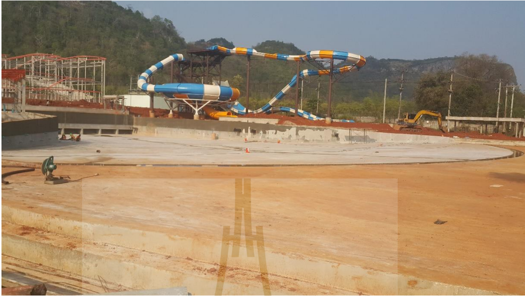
รูปที่ ก.4 สระสวมน้ำก่อนทำการสำรวจรอยแตกร้าว
