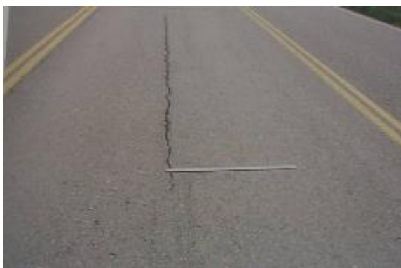
รูปที่ 2.1 รอยแตกแบบไม่ต่อเนื่อง (Non Interconnected Crack) (กรมทางหลวง, 2553)
