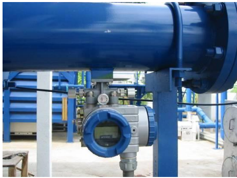
ก. Gas Flow Meter
