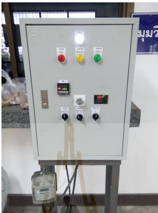
รูปที่ 3.3 ชุดควบคุมอุณหภูมิอากาศอบแห้งพร้อมติดตั้งมิเตอร์
