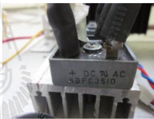
ง. วงจรบริดจ์สำเร็จรูปทำหน้าที่แปลงกระแสไฟฟ้าจาก AC ให้เป็น DC เพื่อที่จะต่อเข้ากับ Capacitor-Tank
