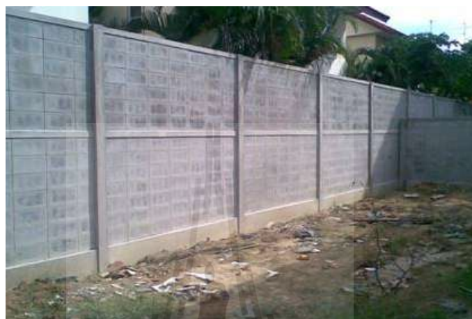
รูปที่ 1.2 ก่อคอนกรีตบล็อกในงานสร้างกำแพง
