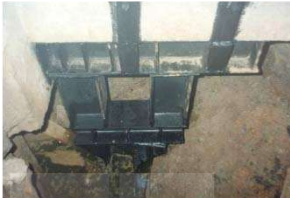
รูปที่ 2.26 การทำ Transfer Beam (คุณชเนศ วีระศิริ บริษัท ฟีนีสส์ ซอสส์ เทสต์ติ้ง จำกัด, ปี พ.ศ. 2544)
