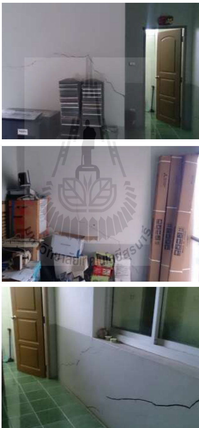
รูปที่ 3.6 รอยแตกร้าวของผนังภายในอาคารตามแนว ก1 ถึง ก14 จนถึงแนว ช1 ถึง ช14
