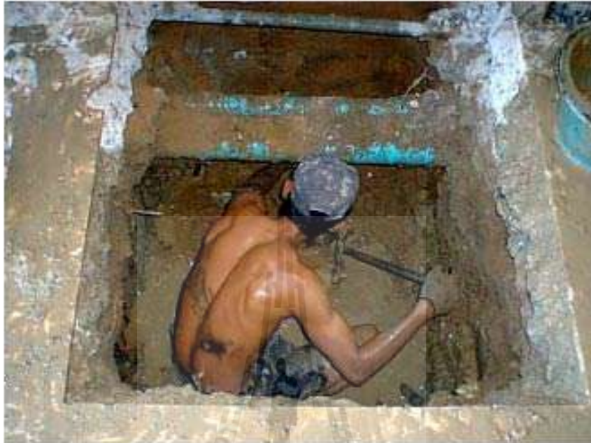
รูปที่ 2.24 การขุดดินบริเวณฐานราก (คุณชนศ วีระศิริ บริษัท ฟิเนสต์ ซอยล์ เทสติ้ง จำกัด, ปี พ.ศ. 2544)
