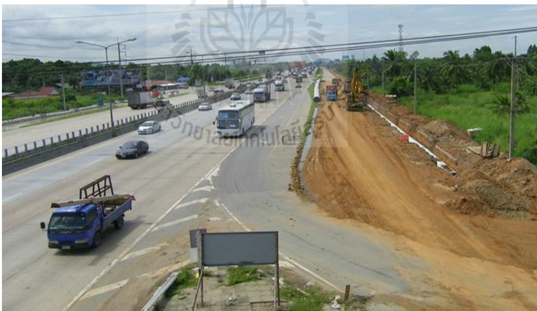
รูปที่ ค.6 สภาพการก่อสร้างในสนามช่วงเข้าทางแยก
