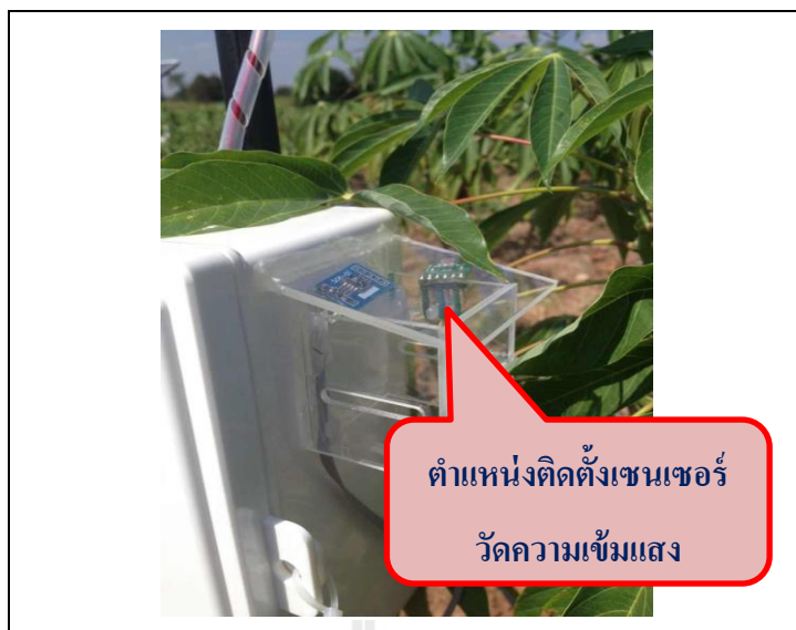
รูปที่ 3.22 การติดตั้งเซนเซอร์วัดความเข้มแสง
