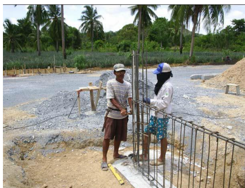
รูปที่ 2.2 การแต่งกายที่ไม่ถูกระเบียบในการก่อสร้าง
