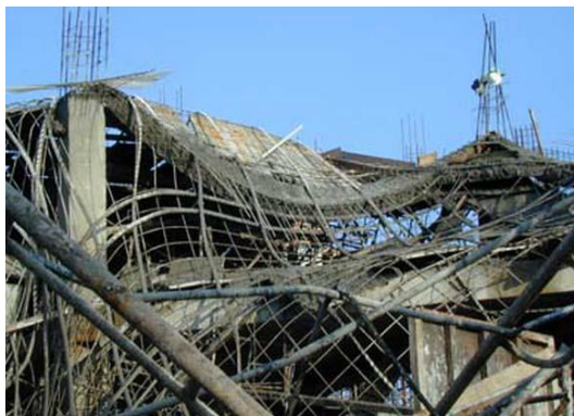
รูปที่ 2.3 การพังทลายของโครงสร้าง
