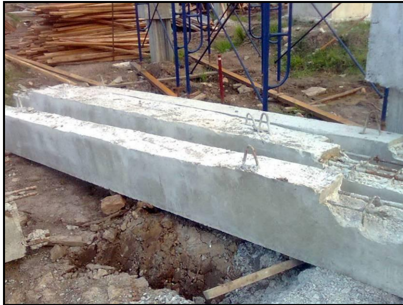
รูปที่ 4.5 คานคอนกรีตสำเร็จที่เทไม่ได้คุณภาพใช้ไม่ได้ต้องเทใหม่
