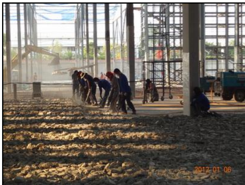
รูปที่ 4.7 สกัดพื้นที่แตกร้าว เพื่อเทคอนกรีตใหม่
