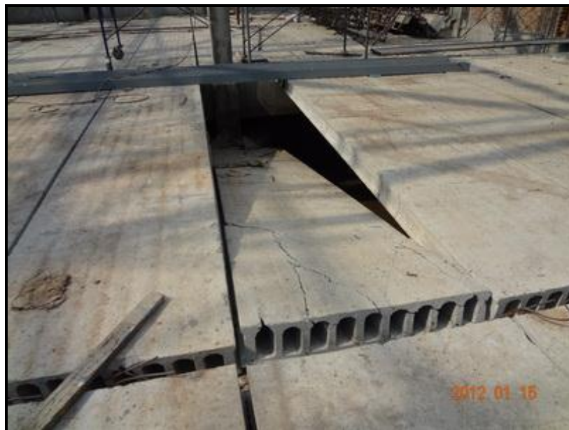
รูปที่ 4.12 การทำงานโดยไม่ระวังทำให้แผ่นพื้นเสียหาย
