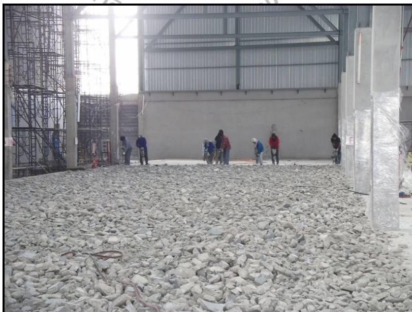
รูปที่ 4.17 สกัดพื้นที่แตกร้าว เพื่อเทคอนกรีตใหม่
