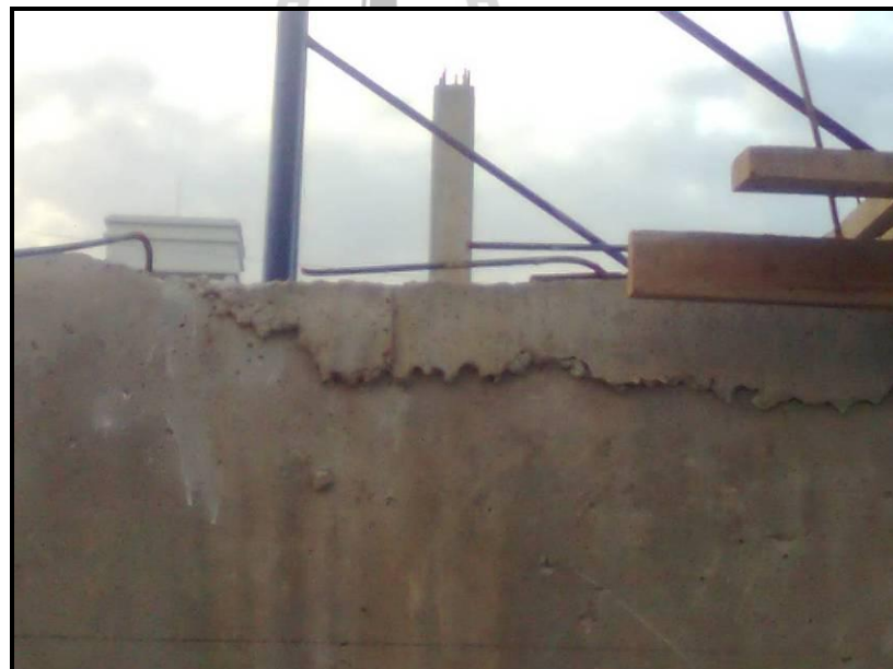
รูปที่ 4.4 สภาพคานคอนกรีตที่เข้าแบบไม่ยึดให้แข็งแรงแล้วเทคอนกรีต
