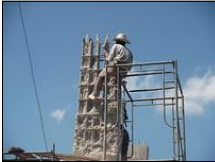
รูปที่ 4.3 เสาคอนกรีตที่เสียหายจากการเทคอนกรีตไม่ได้คุณภาพต้องสกัดทิ้ง
