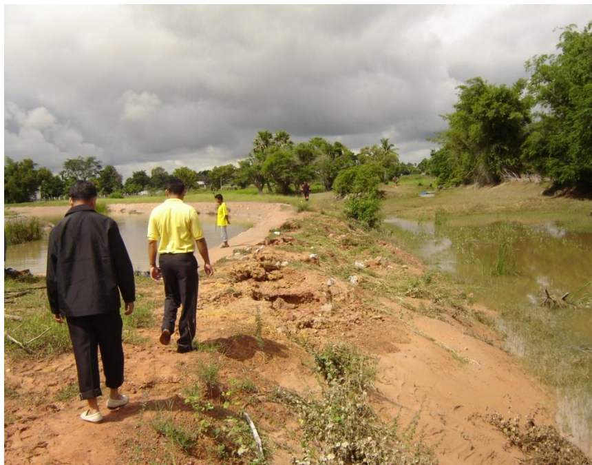
รูปที่ 2.17 ลักษณะการกัดเซาะตลิ่งจุดที่เป็น โถ่งน้ำของคาคอนกรีตพร้อมเรียงหินใหญ่เดิม
