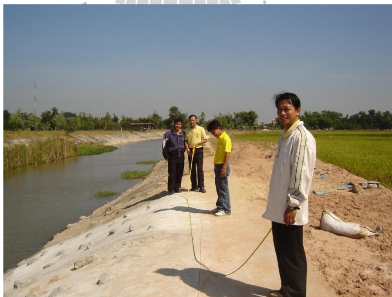
รูปที่ 2.11 ดาดคอนกรีตพร้อมเรียงหินใหญ่ลำน้ำชีสาขา
