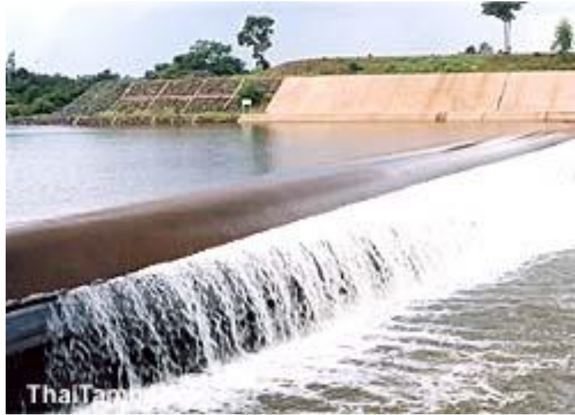
รูปที่ 2.8 คาดคอนกรีตพร้อมเรียงหินใหญ่ลำนน้ำมูลในเขต อำเภอสตึก
