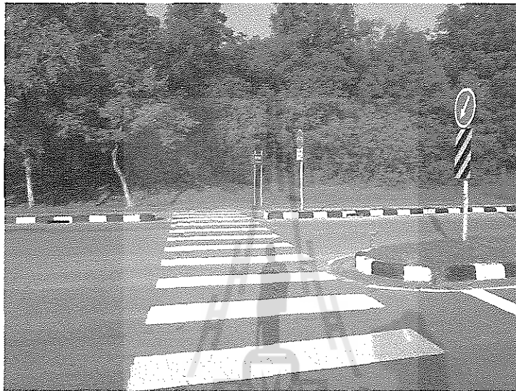
ภาพที่ 4.6ก แสดงไม่มีการติดตั้งปุ่มจราจร
