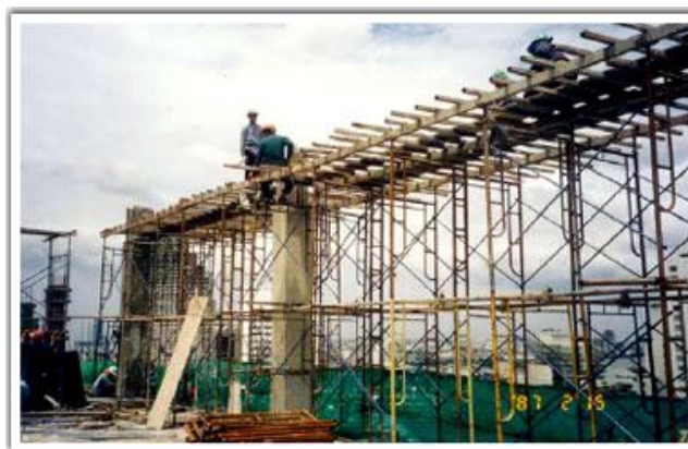
รูปที่ 2.10 ไม่มีอุปกรณ์ความปลอดภัยในการก่อสร้าง
