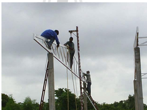
รูปที่ 2.1 ความประมาทของคณงานก่อสร้าง
